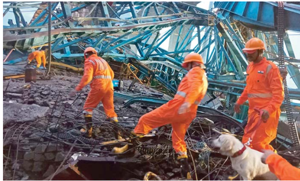
fouriller le site, parsemé de poutres métalliques déformées. L'autoroute Samruddhi, censée relier Bombay et Nagpur, fait partie d'un grand plan de construction d'infrastructures routières dans ce pays à la croissance rapide.
